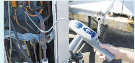
電子式漏えいガス検知器で漏えいを確認
