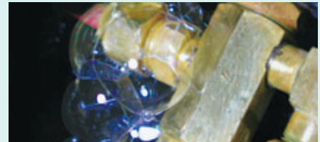
発泡液で漏えいを確認
