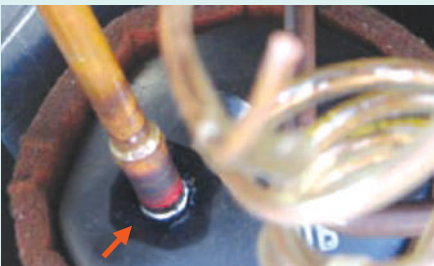
油漏れやしみて漏えいを確認
